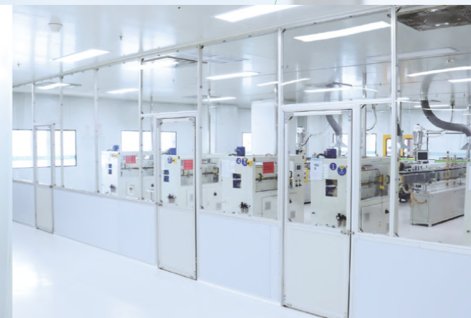
65000m 2 洁净生产车间 建立科学、严谨的无菌生产环境， 确保生产产品高洁净度。
